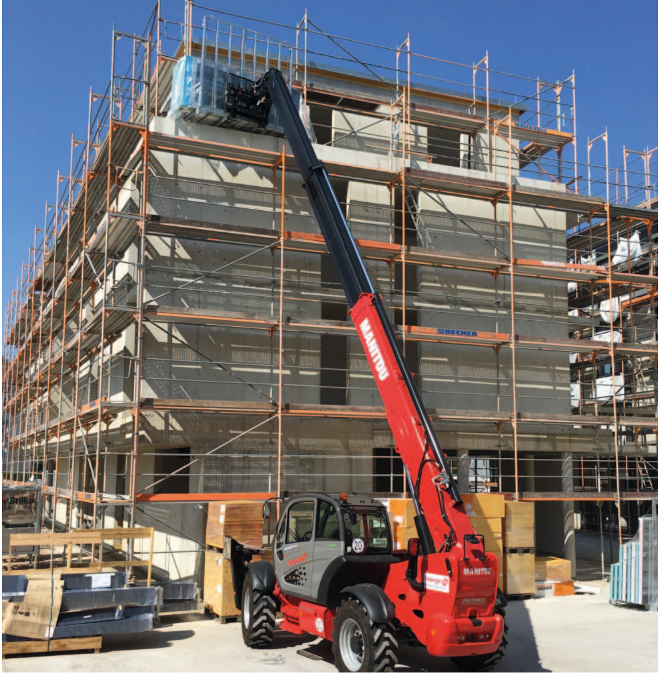
Sichere und arbeits erleichternde Anlieferung der Fenster auch im Obergeschoss mit dem Teleskopstapler.
